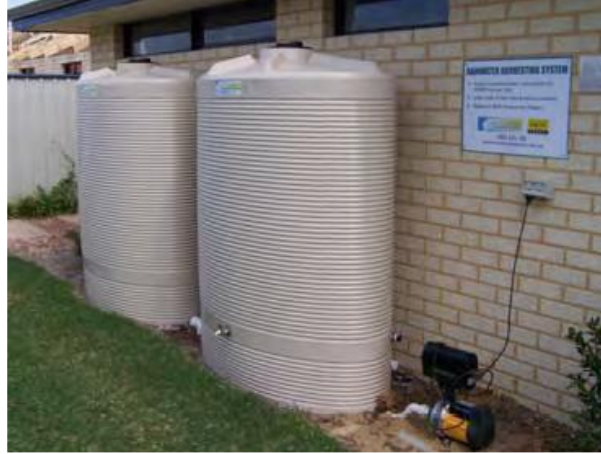
Figura 98. Sistemas de captación de agua de lluvia. Fuente: Department of Water WA, 2005.
