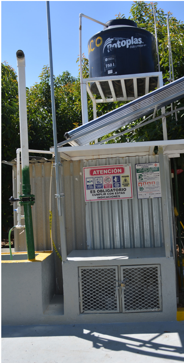
Área para hacer mezclas de agroquímicos. Durante la mezcla de los agroquímicos, los envases vacíos se lavan tres veces antes de perforarse y disponerse en el centro de acopio primario de residuos peligrosos.
